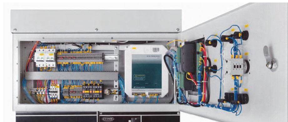
Рис. 3.5.1 Внешний вид релейного отсека
