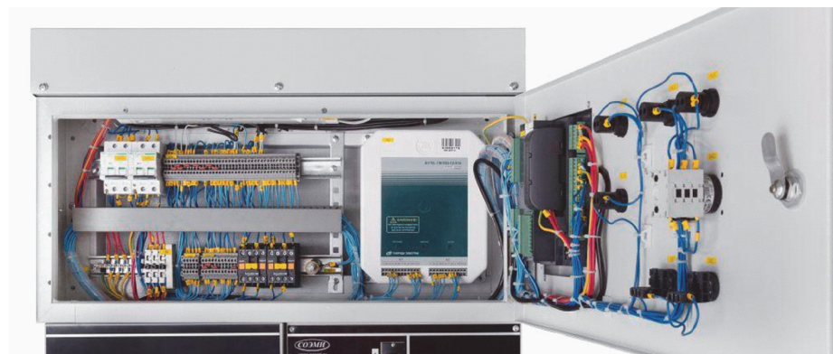
Рис. 3.5.1 Внешний вид релейного отсека
