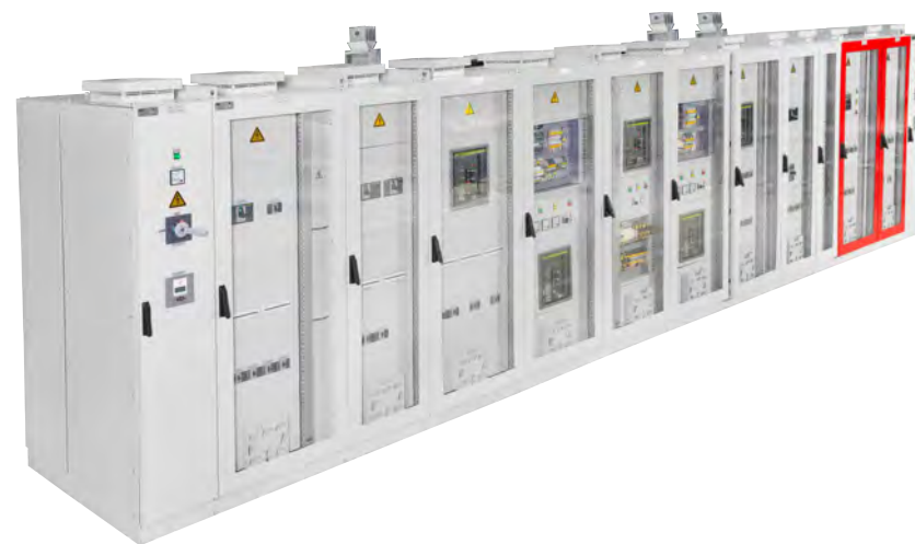
ГРЩ "Оскол" двустороннего обслуживания с присоединительными секциями шинпровода
