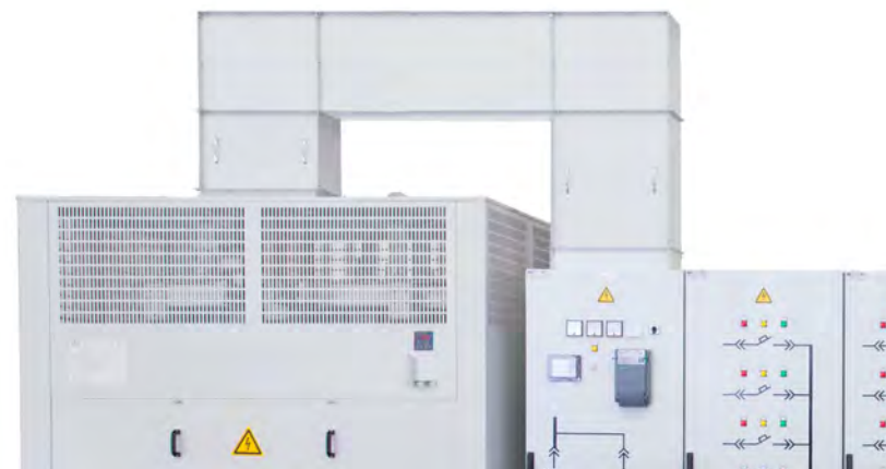
Соединительное устройство на стороне низшего напряжения в составе КТПВ "Оскол"
