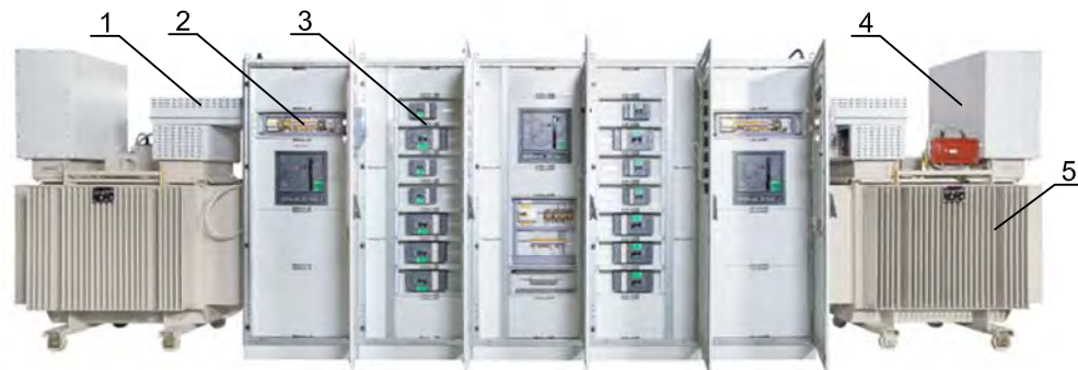
РУНН в составе 2КТПВ "Оскол" с глухим вводом
